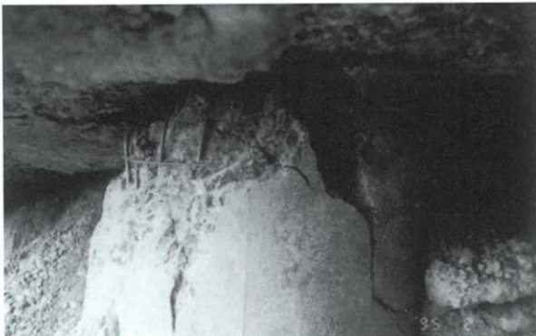
Photo 1 基礎の破損例 Damage to Pile Foundation
