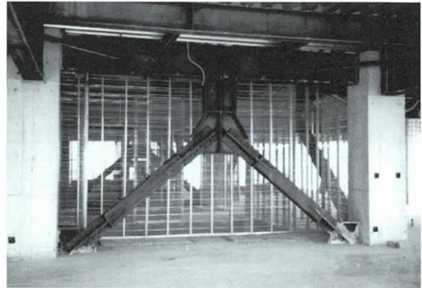
Photo 4 Y形ブレースによる耐震補強 Retrofitting with High Damping Brace
