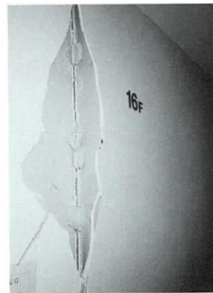
Photo 3 GL工法による石膏 ボードの脱落 Fell Away Plaster Board Built by GL Method
