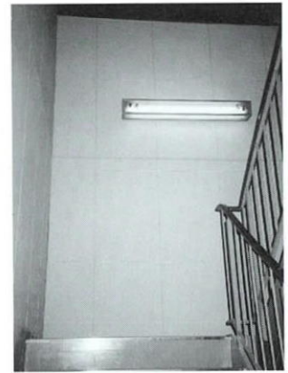
Photo 4 無傷であった ロンレックス耐火壁 RONLEX Fire Resistant Wall in Perfect Condition
