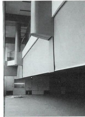
Photo 1 ロール式垂れ壁 Rolled Up Curtain for Smoke Prevention
