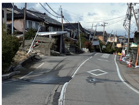
液状化による被害 (内灘町) Damage due to Liquefaction
