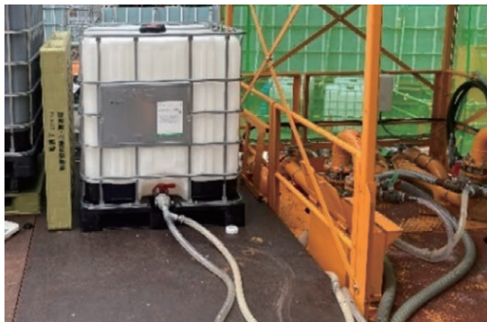
安定液プラントへ SSDH 投入 SSDH input to slurry plant
